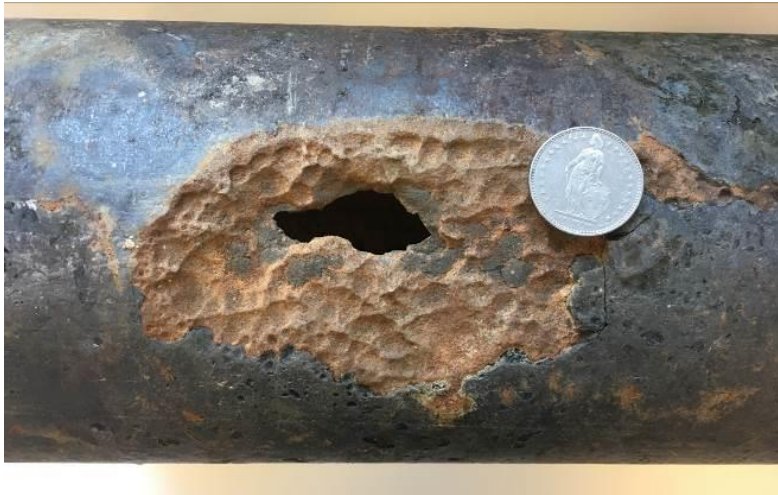
Fuite d'eau 2'700 litres/minute route de Champoz , détail du tuyau 14.05.2019
